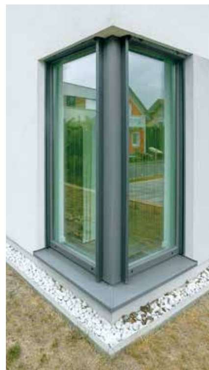
Háromrétegű üvegezésű hőszigetelt sarokablak egy passzívháznál
