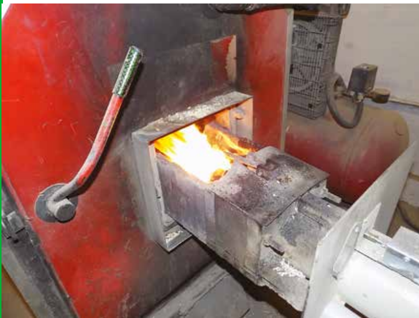
Ha sikerül jól beszabályoznunk a berendezést, akkor az égés látványos és hatékony.
