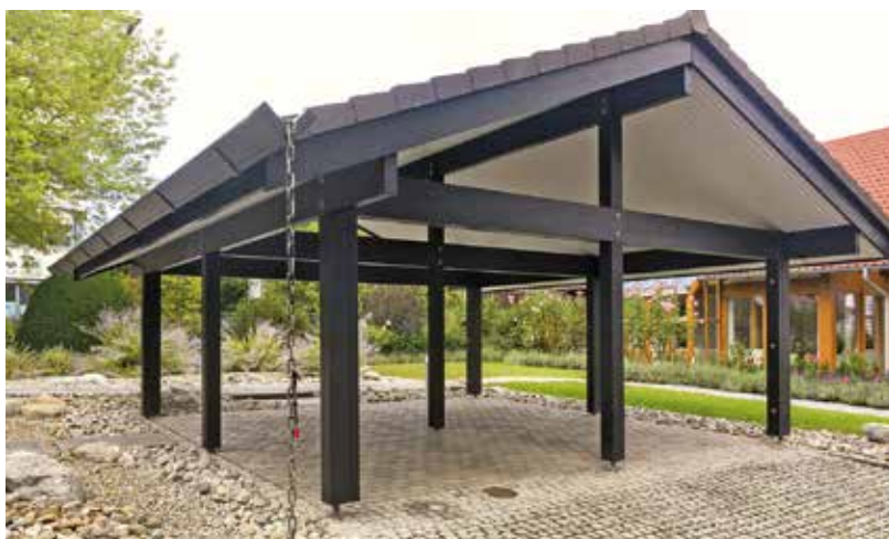
Szereltváz, faszkerzetű, két jármű fogadására alkalmas autóbeálló, igényes környezetben. Itt megkérdőjelezhető a stabilitás az acéloszlopos alapcsatlakoztatás és a szélrács hiánya miatt
