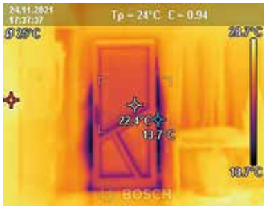
Hibás ajtóbeépítés feltárása.
