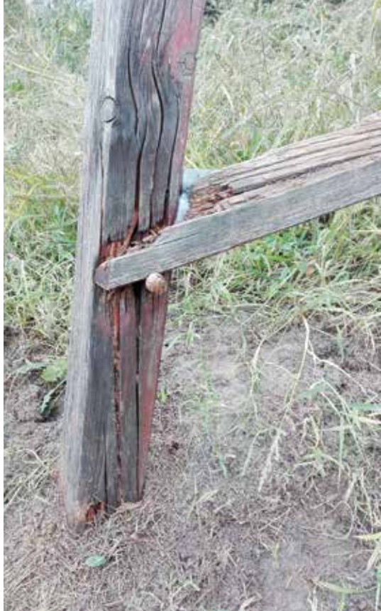
2. kép: Korhadt és repedezett balesetveszélyes hintalábak
