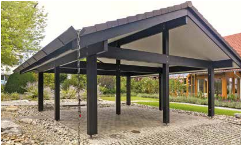
Szereltváz, faszkeretű, két jármű fogadására alkalmas autóbeálló, igényes környezetben. Itt megkérdőjelezhető a stabilitás az acéloszlopos alapcsatlakoztatás és a szélrács hiánya miatt
