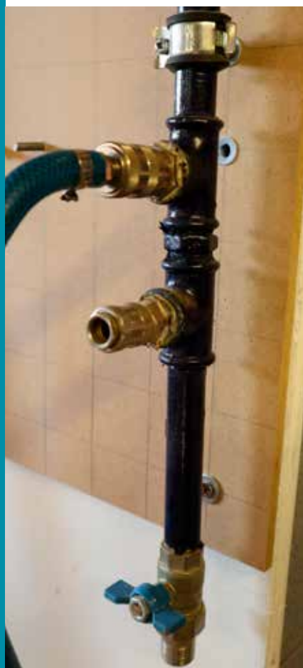
Két kiállásos acélcsöves végpont a „vízsákkal”.
