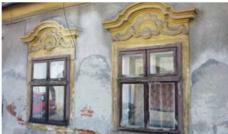
Különleges ablak kívülről záródó, de befelé nyíló alsó szárnyakkal. Csak kézműves munkával volna megmenthető
